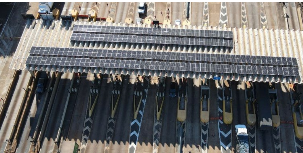
Plantas de autogeneración con placas solares
